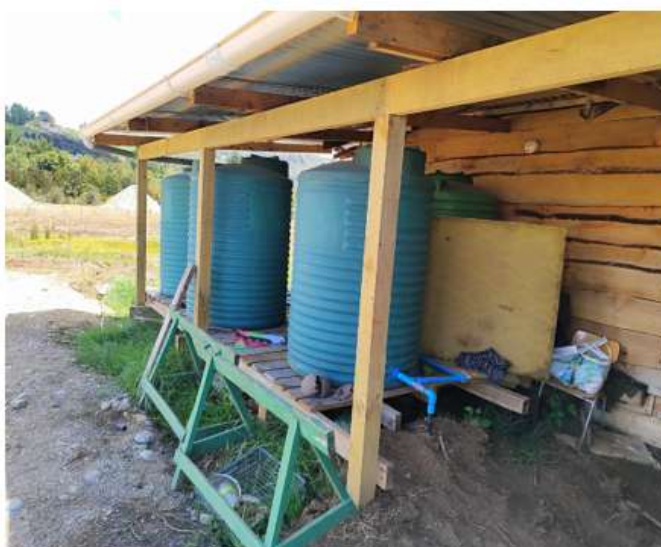
Figura 7: Sistema de recolección de aguas lluvia, fundo Alto Gamboa. Elaboración propia 2024)
