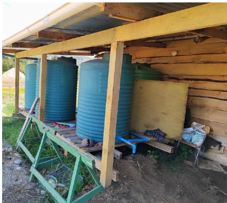
Figura 11: Sistema de recolección de aguas lluvia, Fundo alto Gamboa. Elaboración propia (2024)
