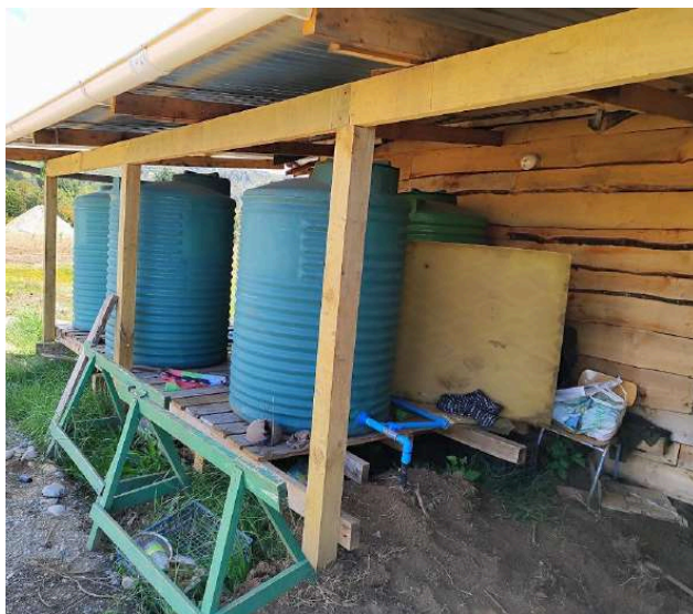
Imagen 15: Sistema de recolección de aguas lluvia
