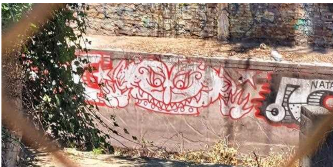
Foto N° 8: Graffitis en muros de contención del Canal San Carlos, Peñalolén.
